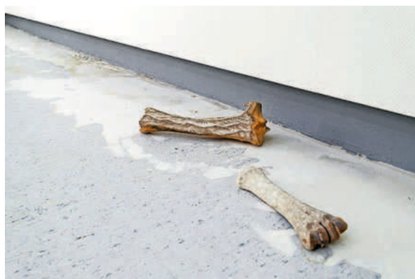
Vloedlijn langs de plinten van Afslag BLV.
